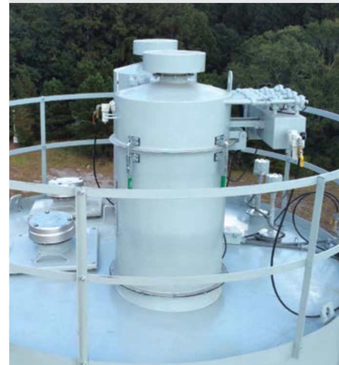
COLECTOR DE POLVO MONTADO SOBRE SILO
