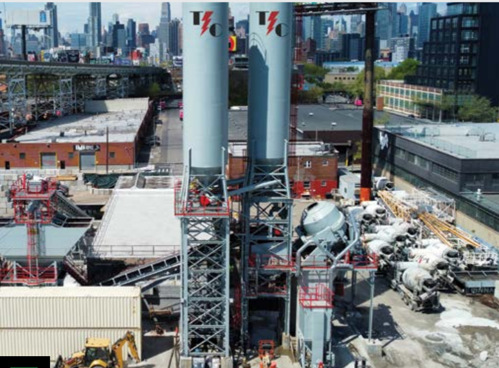
LPM EN COMBINACIÓN CON UNA MEZCLADORA INCLINABLE ESTACIONARIA DE 12 YD 3
